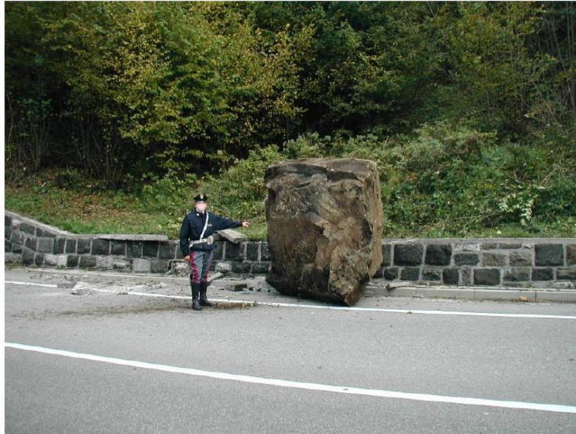
Figura 23: frana di crollo. Si tratta di una frana in località Venas in comune di Vodo di Cadore (BL), lungo la SS 51, nella sede stradale si sono posizionati quattro massi con volume compreso tra 0,5 e 5 mc
